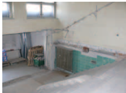
Nástup hlavního schodiště v úrovni hlavního vchodu, stav během odbourání druhotných zásahů (foto Marie Bartošová, 2014).
